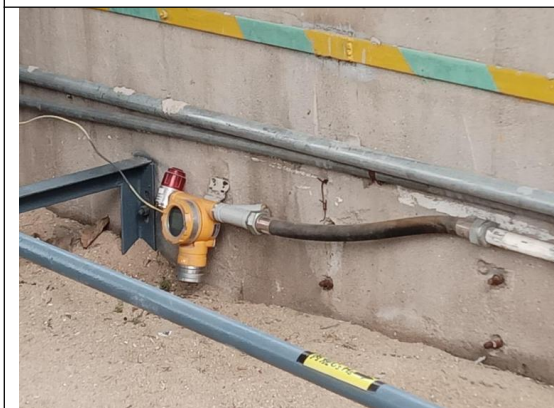
罐区内泄露报警器
