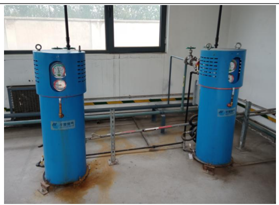
丙烷间储存装置
