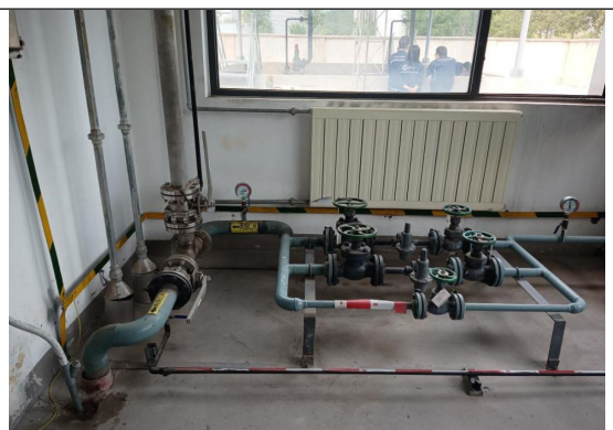
丙烷间管道阀门
