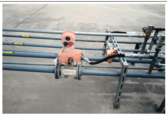
丙烷罐区管道泄露报警装置
