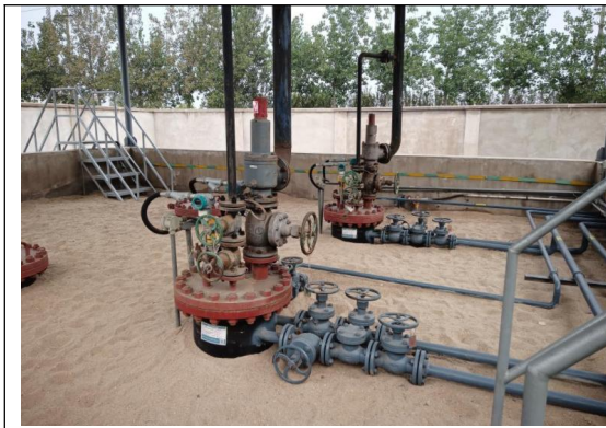
丙烷罐区及围堰
