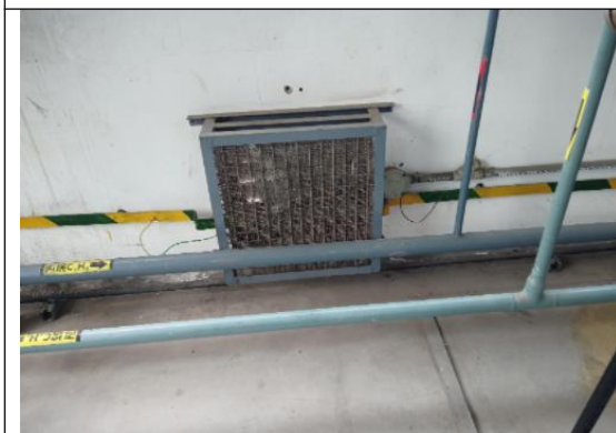
丙烷间可燃气体探头及风机
