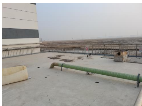
污泥浓缩储池
