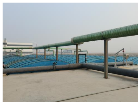
污水处理密封设施
