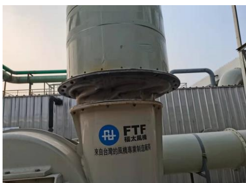
生物除臭系统出口风机软连接
