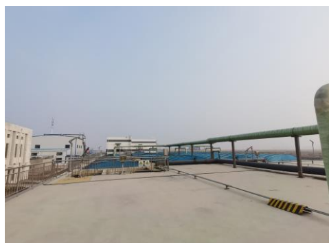
缺氧池和好氧池
