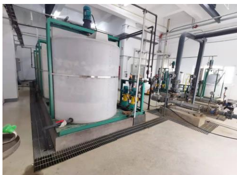
加药间泄露收集渠
