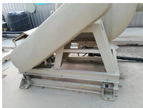
生物除臭系统出口风机减震措施
