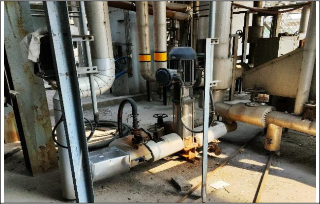
丁辛醇一期装置区提升泵
