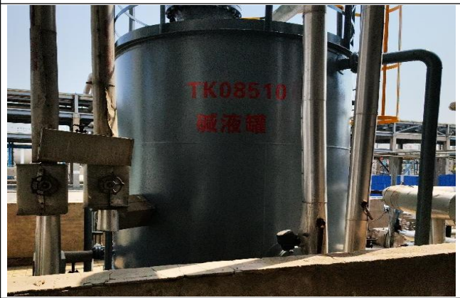
丁辛醇一期装置区碱液罐
