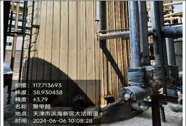
聚甲醛装置区碱液罐
