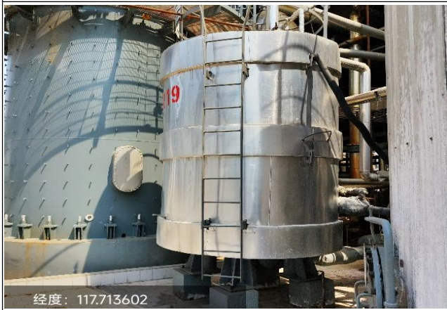
聚甲醛装置区酸液罐
