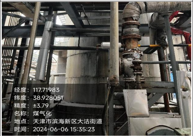
煤气化装置区废水罐
