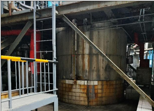
煤气化装置区盐酸罐
