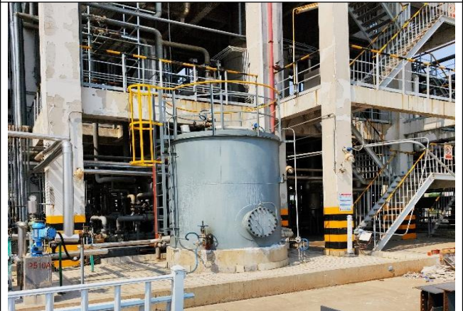
丁辛醇二期装置区碱液罐
