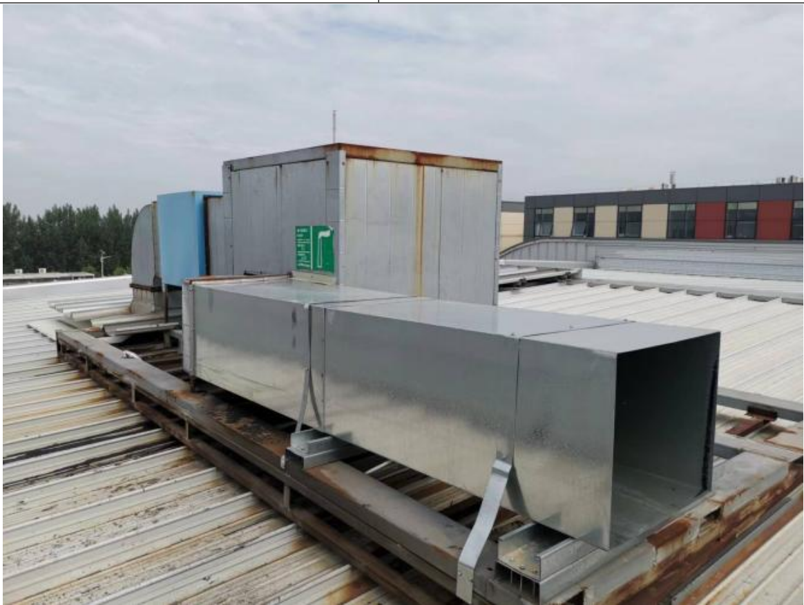
排气筒 P12 采样平台及标识牌
