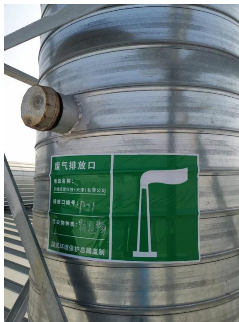
排气筒 P21 采样口
