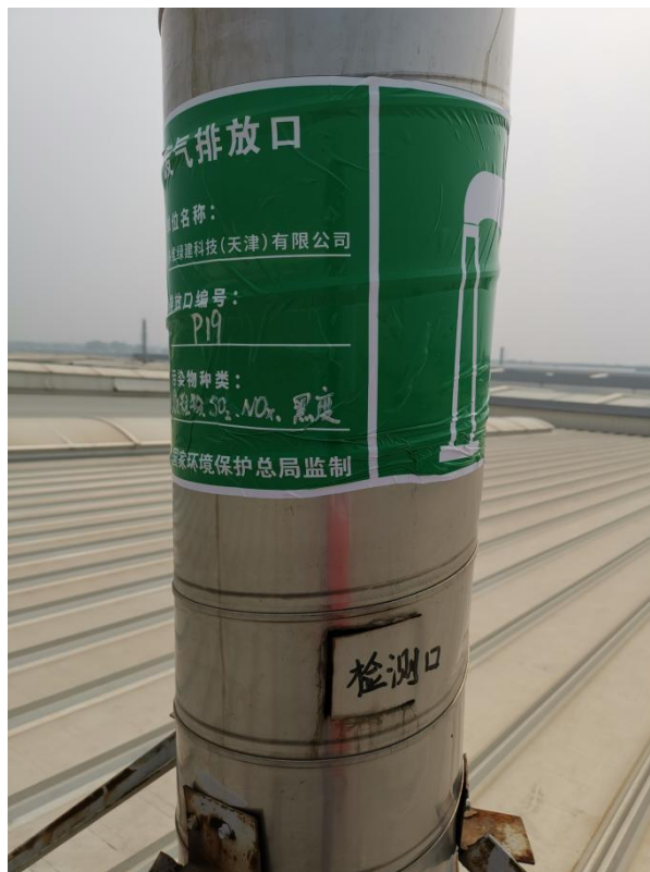
排气筒 P19 采样口
