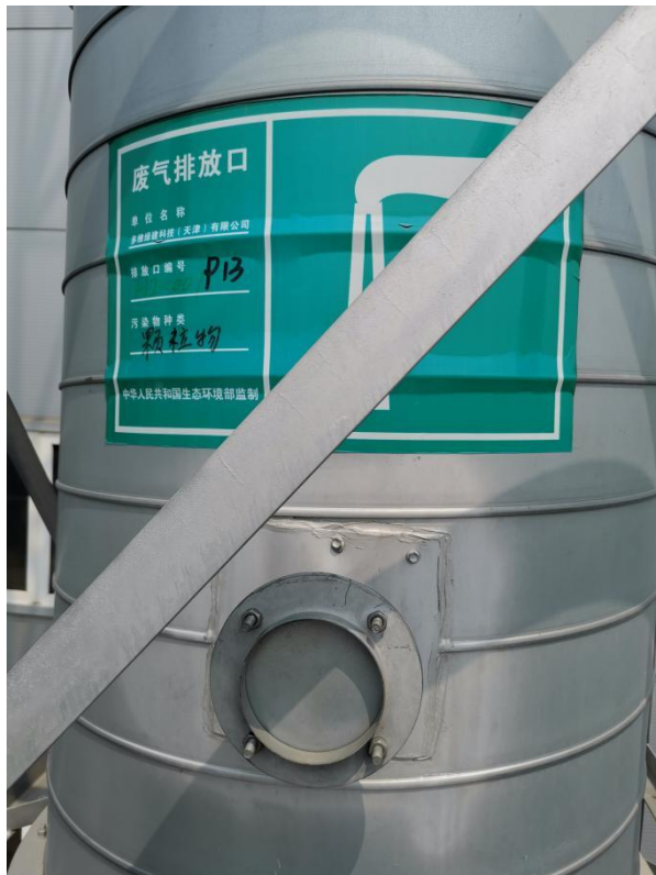
排气筒 P13 标识牌及采样口
