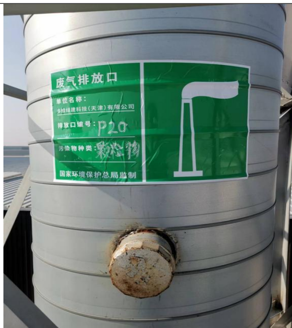
排气筒 P20 采样口
