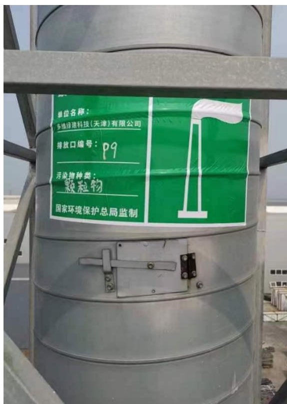
排气筒 P9 采样平台及标识牌
