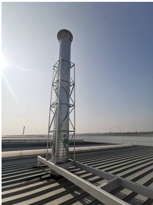
排气筒 P21 采样平台及标识牌
