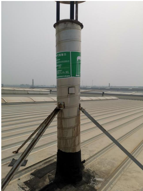
排气筒 P19 采样平台及标识牌
