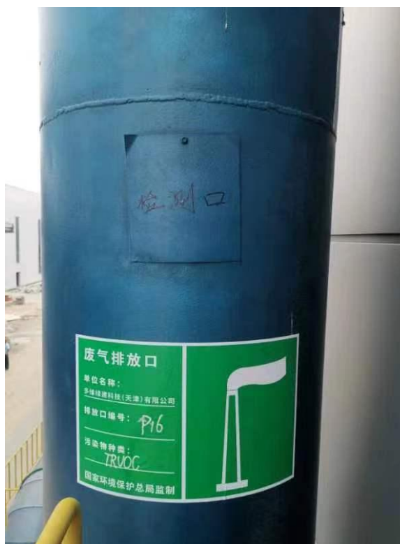
排气筒 P16 标识牌及采样口
