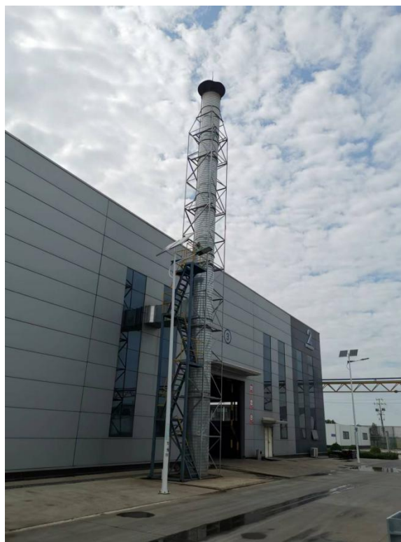
排气筒 P17 及采样平台
