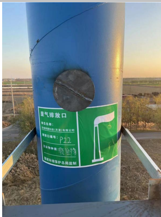
排气筒 P22 采样口
