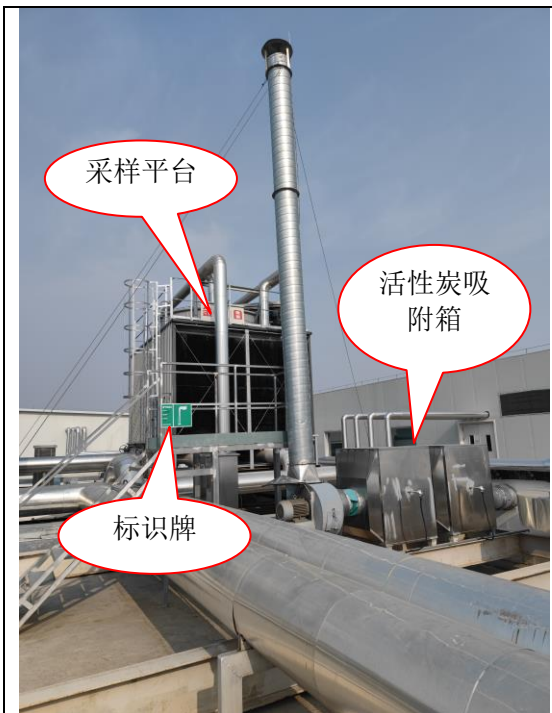
DA001 排气筒及采样平台
