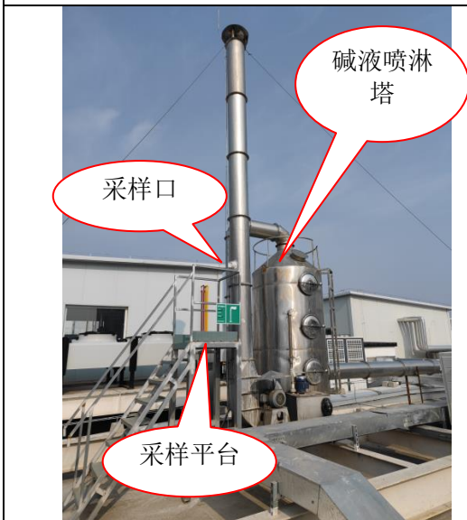
DA002 排气筒及采样平台
