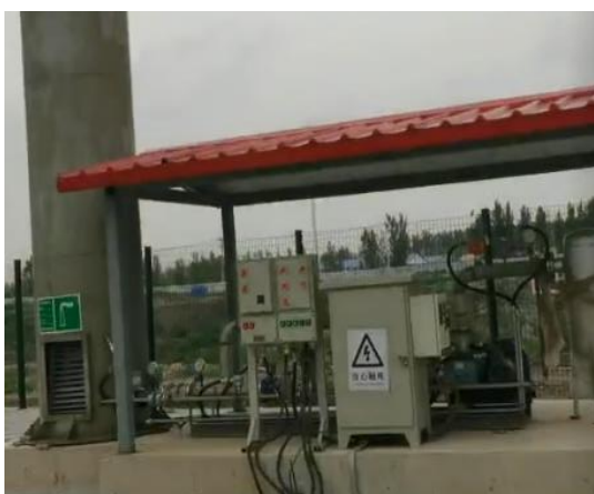
废气处理设施
