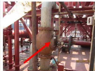
阀门：垫片，温石棉 (5%-50%) 石棉垫片广泛使用在各阀门中，更换难度大
